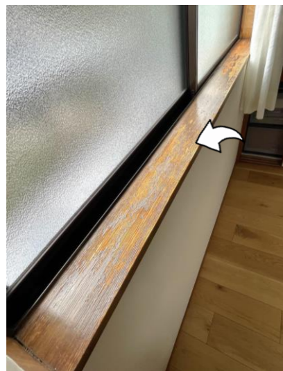
結露で、木製の窓枠が傷んでポロポロに
